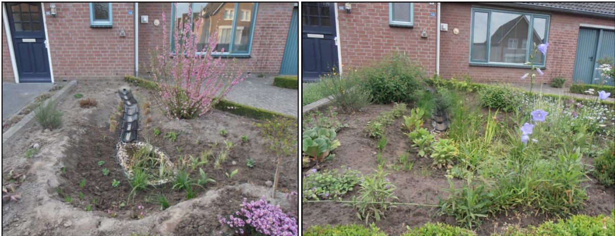
Figuur 77: Regenwater naar wadi in voortuin (links: aanleg wadi, rechts: wadi voltooid) (Van Eck, G., sd)
